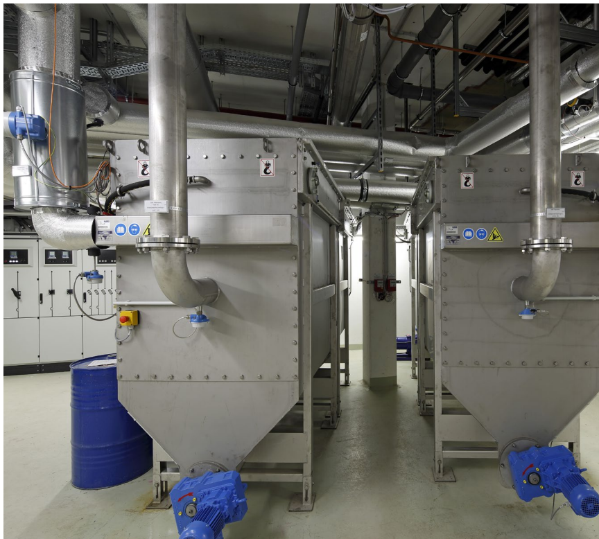
Blick in die Technikzentrales des Museums.
